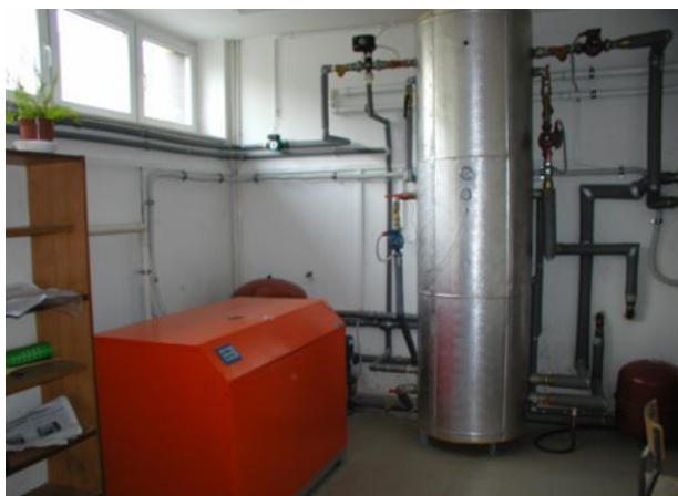
Pompa ciepła w Gimnazjum Nr 1 w Miechowie
