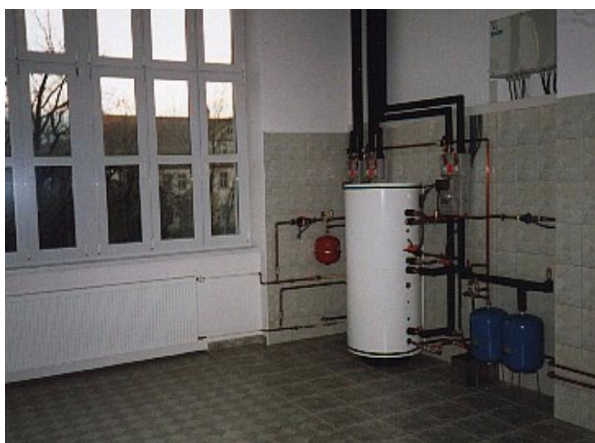
Wzorcowa instalacja solarna
